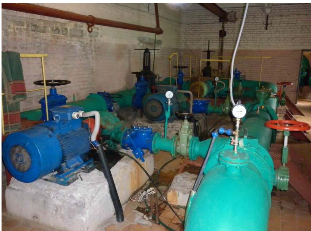
Рисунок 15. Насосное оборудование ВНС №1 «Главная»
