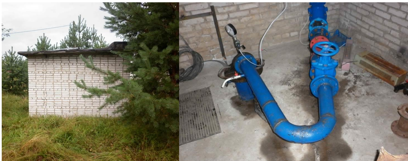
Рисунок 9. Внешний вид и оборудование скважины №11
