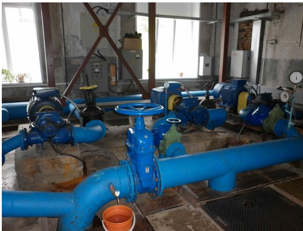
Рисунок 18. Насосное оборудование ВНС №2 «Центральная»
