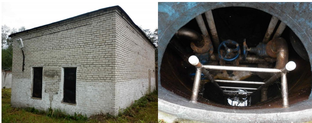
Рисунок 46. Внешний вид и оборудование КНС «Индустриальная»
