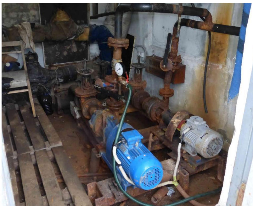
Рисунок 29. Насосное оборудование ВНС мкр. Сертолово-1, (в/г Сертолово-3)
