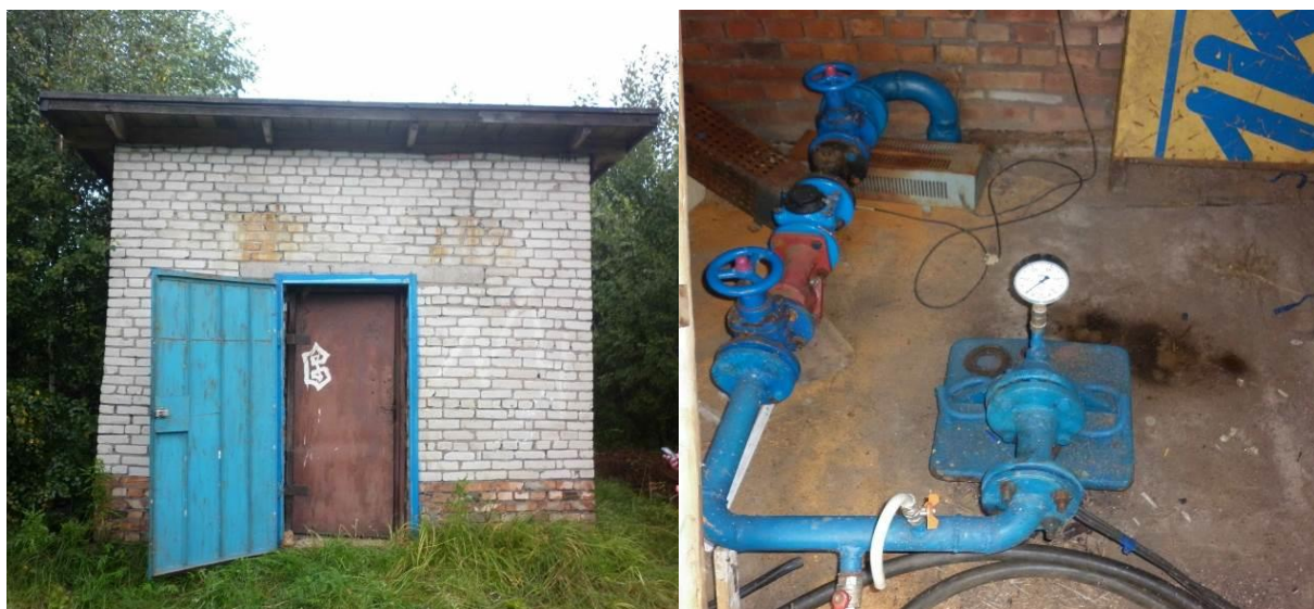
Рисунок 4. Внешний вид и оборудование скважины №4
