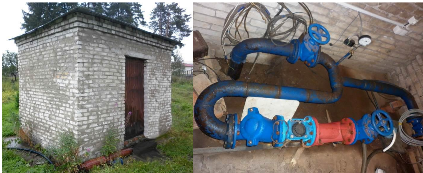
Рисунок 7. Внешний вид и оборудование скважины №8
