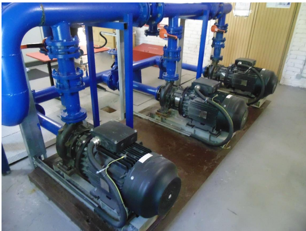
Рисунок 21. Насосное оборудование ВНС №8 (мкр. Сертолово-2)
