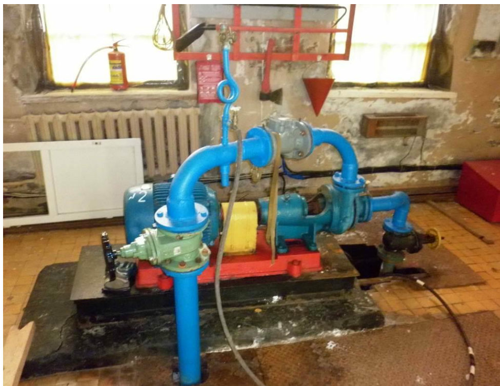
Рисунок 24. Насосное оборудование ВНС №1 (мкр. Черная Речка)
