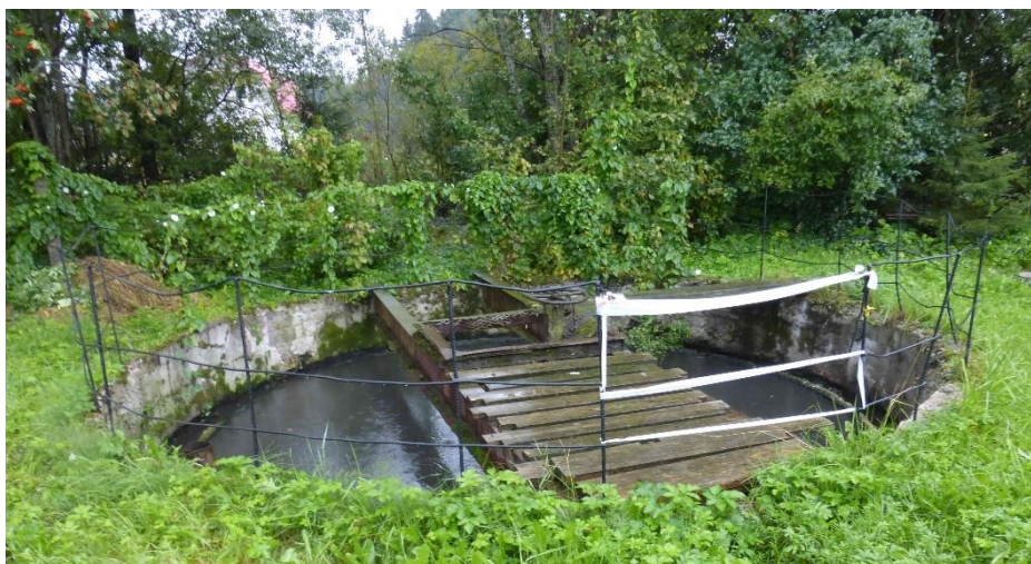
Рисунок 45. Контактный резервуар КОС мкр. Черная Речка
