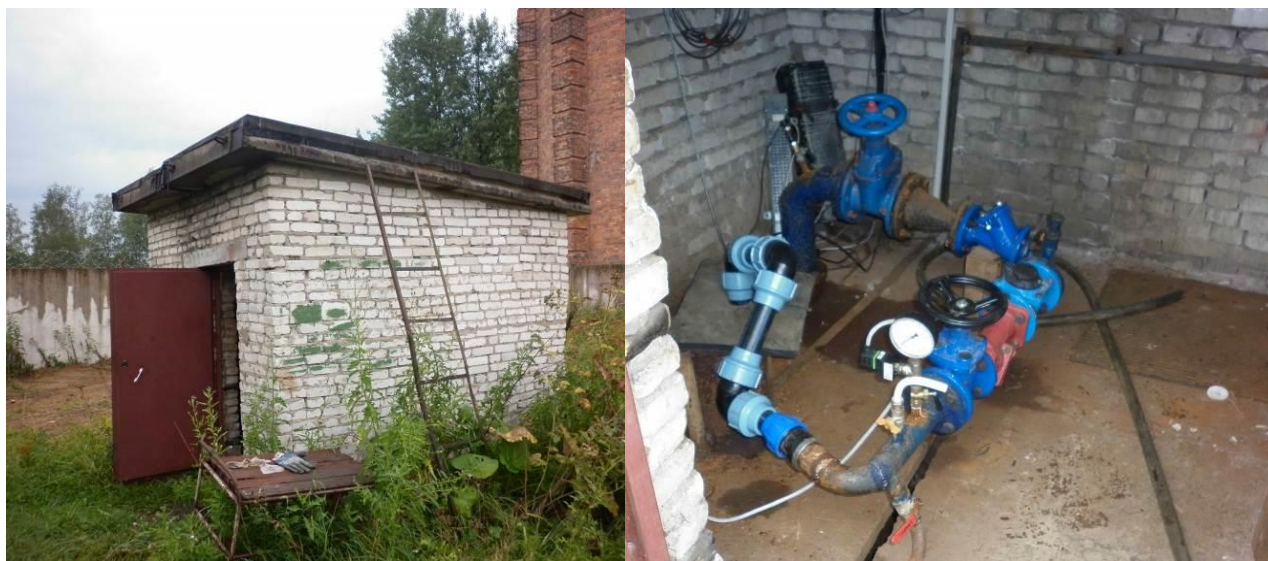
Рисунок 5. Внешний вид и оборудование скважины №6
