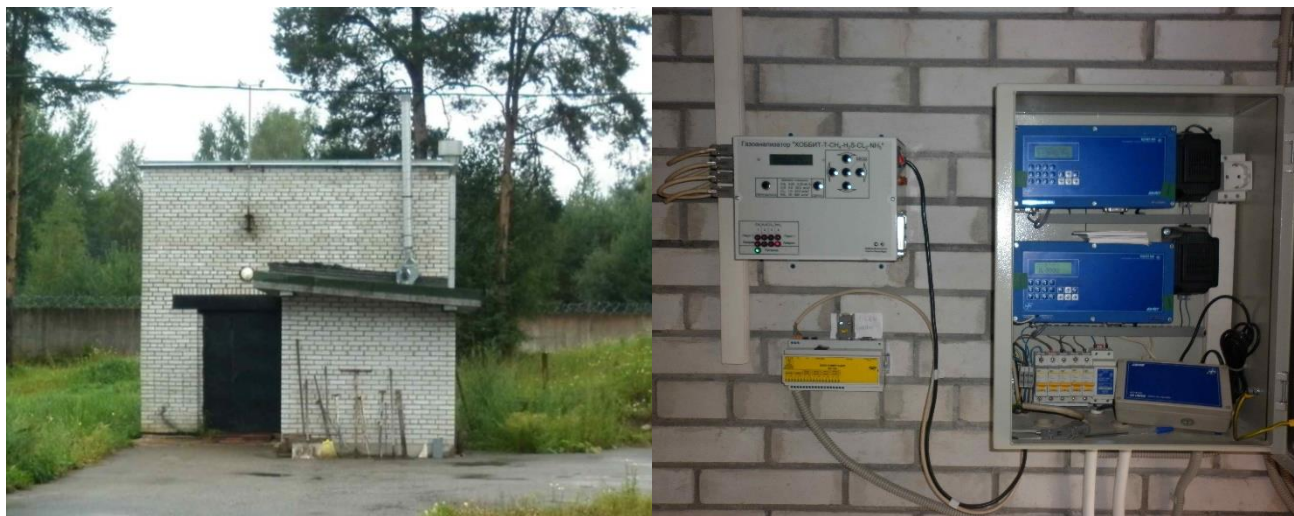
Рисунок 49. Внешний вид и оборудование ГКНС
