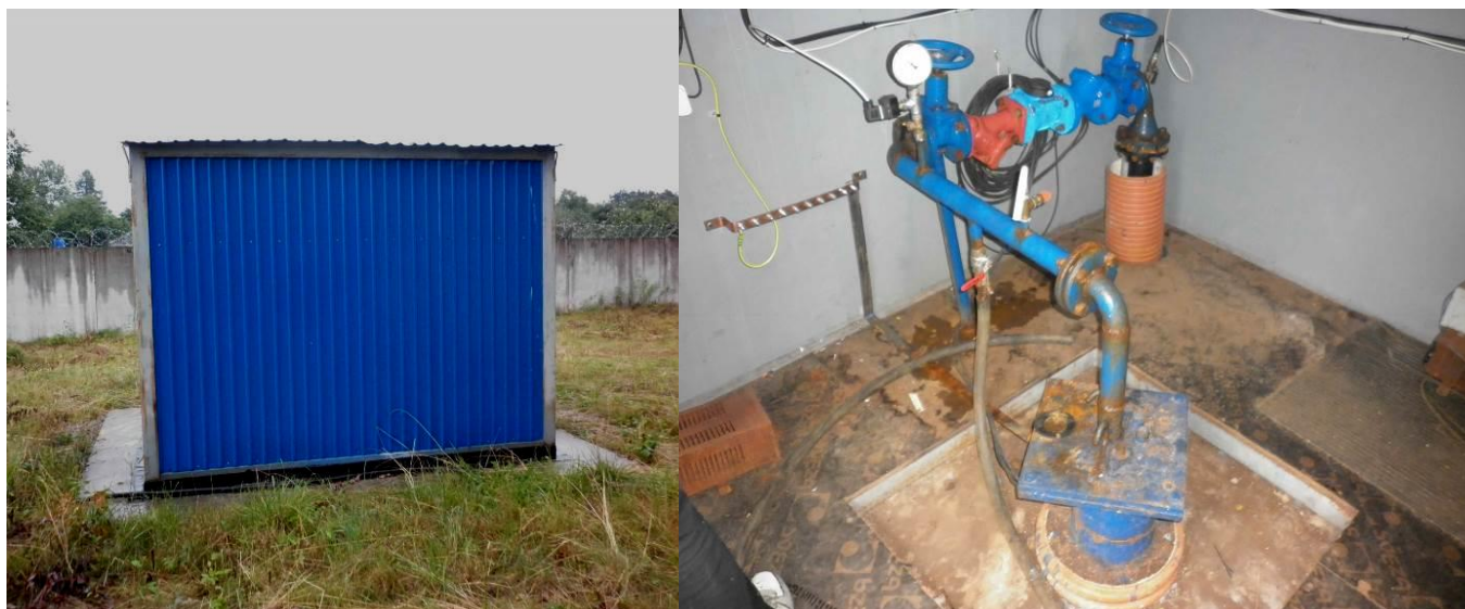
Рисунок 6. Внешний вид и оборудование скважины №7
