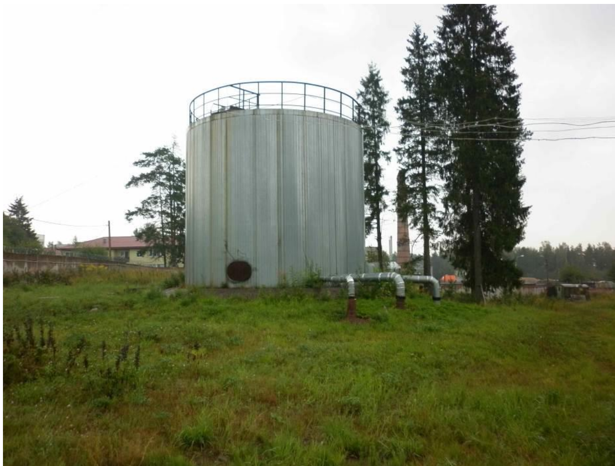
Рисунок 27. Резервуары чистой воды ВНС №2 (мкр. Черная Речка)
